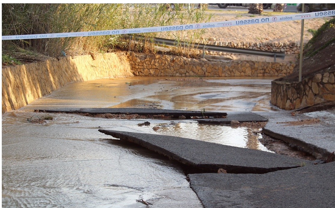
Un dels punts per on baixa aigua de la canonada rebentada a l'Ampolla. | ACN
